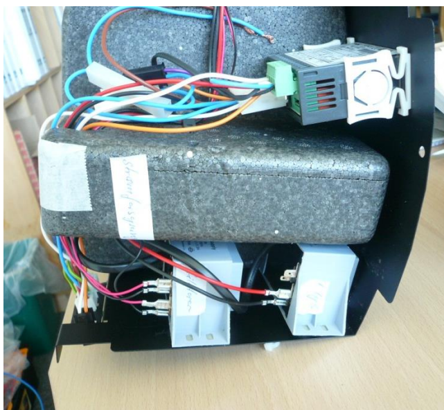
Figur 9-22 Blæserkasse assembly med transformatorer nederst i billedet.
