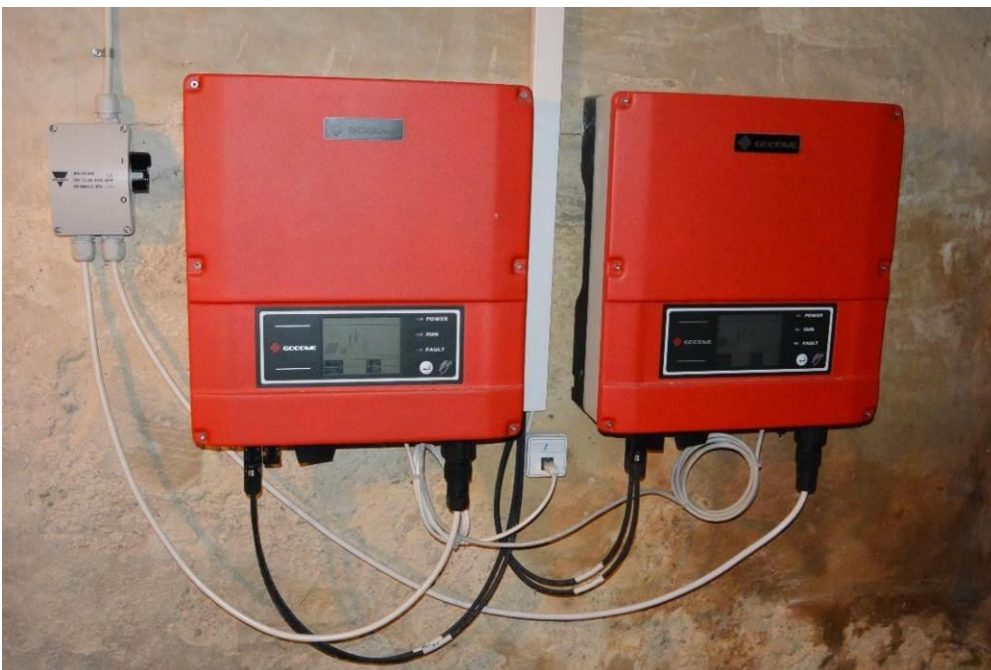
Fig 1.7. 5 6 kWp 'inverter' til 8 kWp solceller ifm energirenovering i Sorø (4,5 kWp på hustag og 3,5 kWp i hæk og garagetag)
