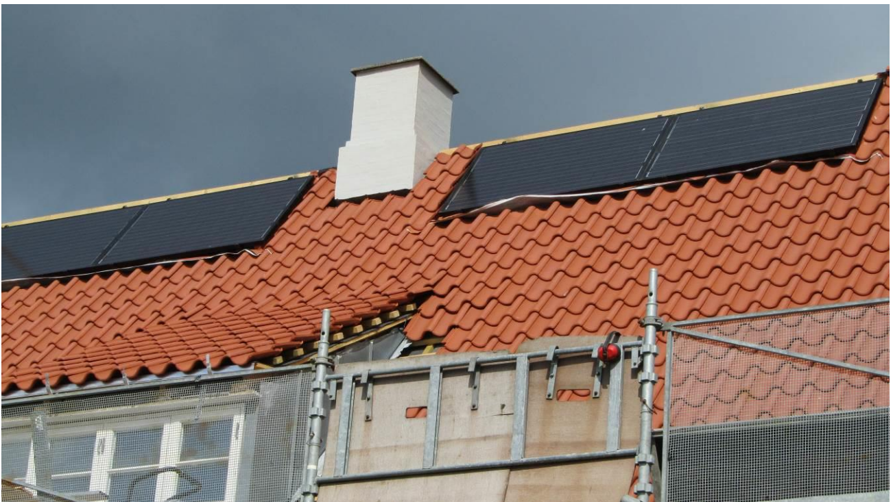
Fig 1.7. 9 Solcelle modulerne på hovedbygningen er nedfældet i det nye tegltag på samme måde som BPS foreskriver for solfangere. Solceller både mod øst og vest.
