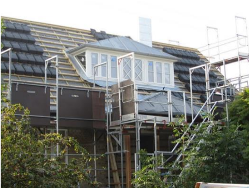
Fig 1.6. 4 Enfamiliehus i Valby med ekstra overetage, som blev forberedt for tagindpassede ventilationsenheder med varmegenvinding, hvor elforbruget modsvares af el fra solceller i taget
