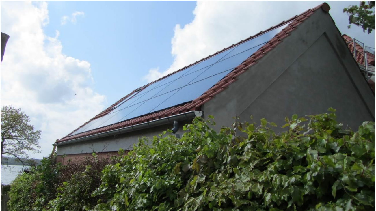
Fig 1.7. 8 Solceller på renoveret garagebygning
