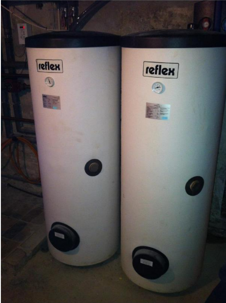
Varmtvandsbeholdere i kælder. Den ene er inaktiv da solvarme ikke kører.
