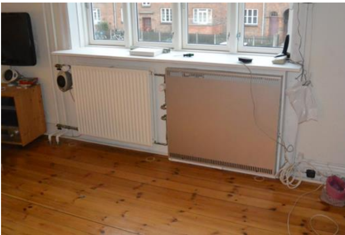
Fig 1.6. 6 Den vinduesintegrerede varmegenvindingsenhed blev kombineret med en mindre udgave af den eksisterende radiator a.ht. afregning
