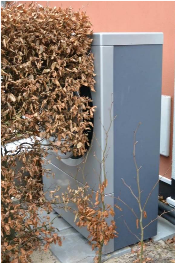
Fig 1.7. 14 Den energieffektive luft/vand varmepumpe fra Danfoss (DHP-AQ-13) med ude-enhed placeret sammen med hæk mod gadeområde tæt på indgangsparti
