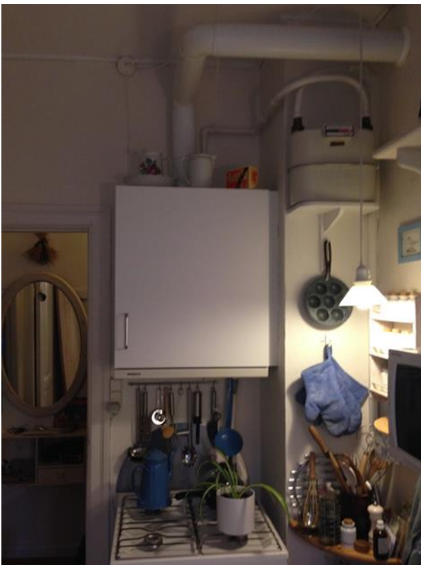
Fig 1.6. 10 Emhætte i køkkenet blev ændret til en recirkuleringsemhætte med kulfilter
