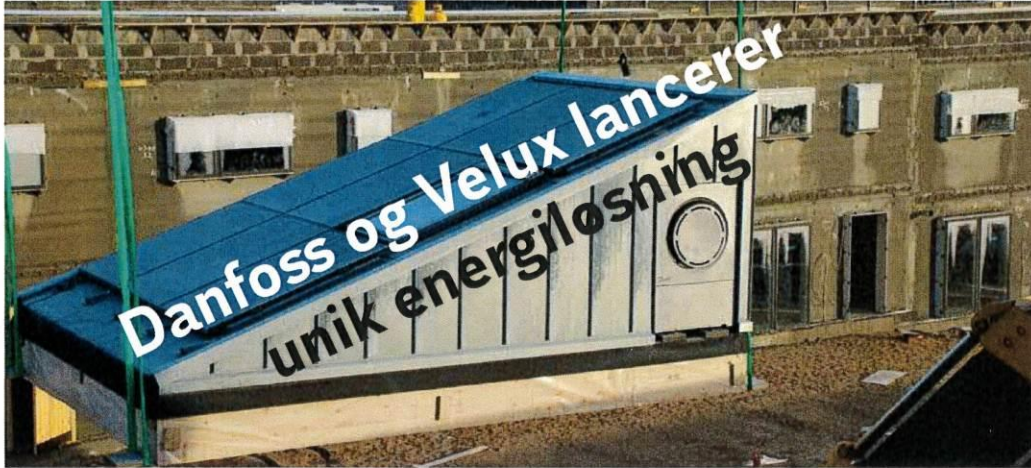
© Solar Prism løftes på plads i Tranbjerg ved Aarhus. Produktet er nomineret til DI's Produktpris 2012, som uddeles i morgen 25. september på DI Topmodet. //Velux
