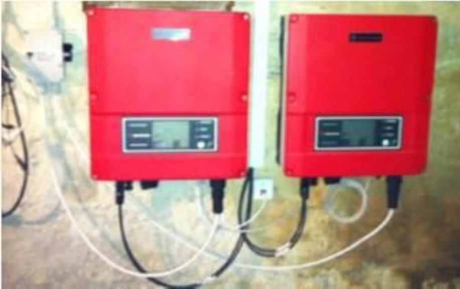
Invertere i kælderrum
