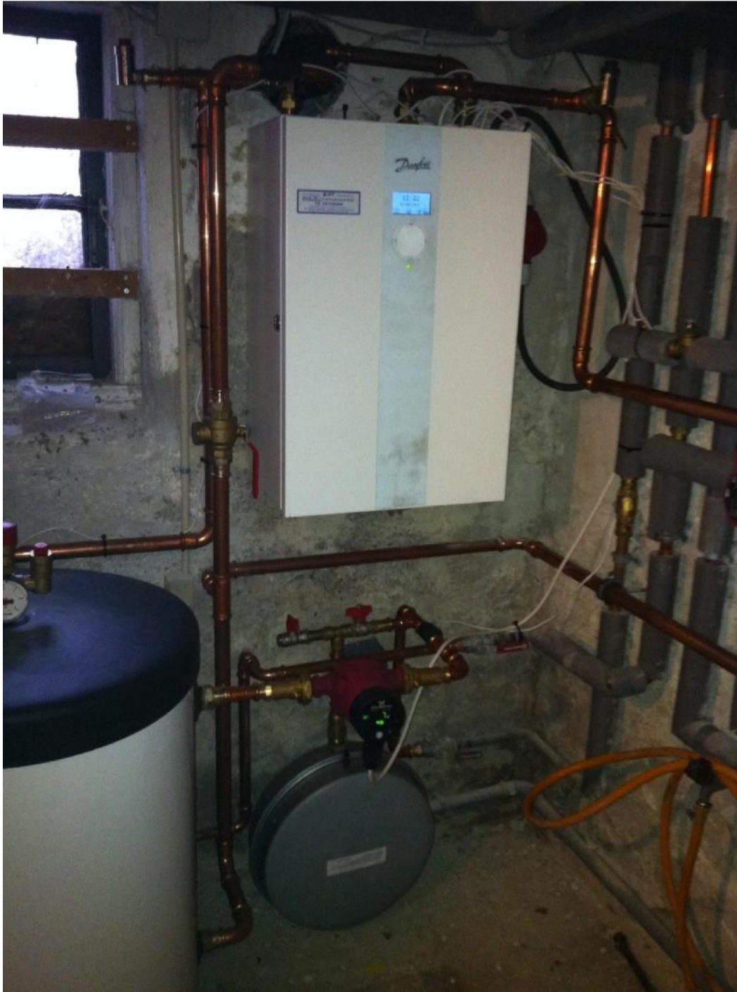
Varmepumpe fra Danfoss. 100 liter buffertank til venstre.
