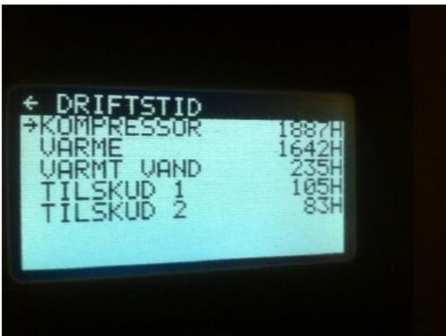
Displayvisning 2/9. Varmepumpen er monteret 24/10 2013
