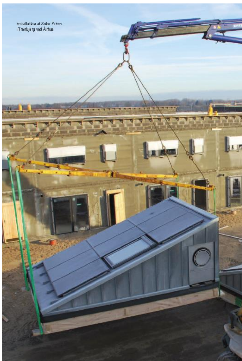
Fig 1.5 5 Foto af solprisme med solceller, VELUX vindue og varmepumpe, som blev anvendt i 60 nybyggede boliger i Tranbjerg ved Aarhus v. Brabrand Boligforening.
