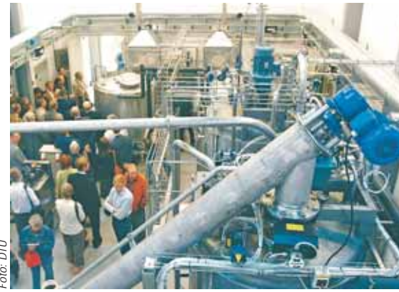
BioGasols første pilotanlæg Maxifuel på DTU.
