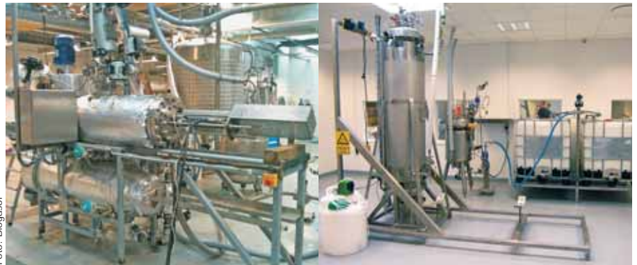
Biogasols pilotanlæg til henholdsvis forbehandling af biomasse (til venstre) og til fermentering af C5 sukker (til højre). Begge anlæg er placeret hos virksomheden i Ballerup, der i dag har 30 ansatte. Teknologien skal nu opskaleres til et pilotanlæg med en årlig produktion på fem millioner liter bioethanol, 3.000 MWh el og 7.000 tons biopiller.
