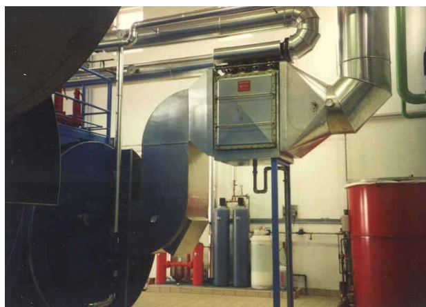
Economizer installeret efter gaskedel
