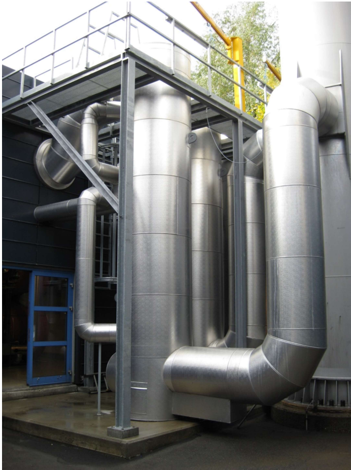
Figur 18 Ekstra røggaskøler for røggas fra motorbaserede kraftvarmeheder; her er veksleren placeret udendørs.
