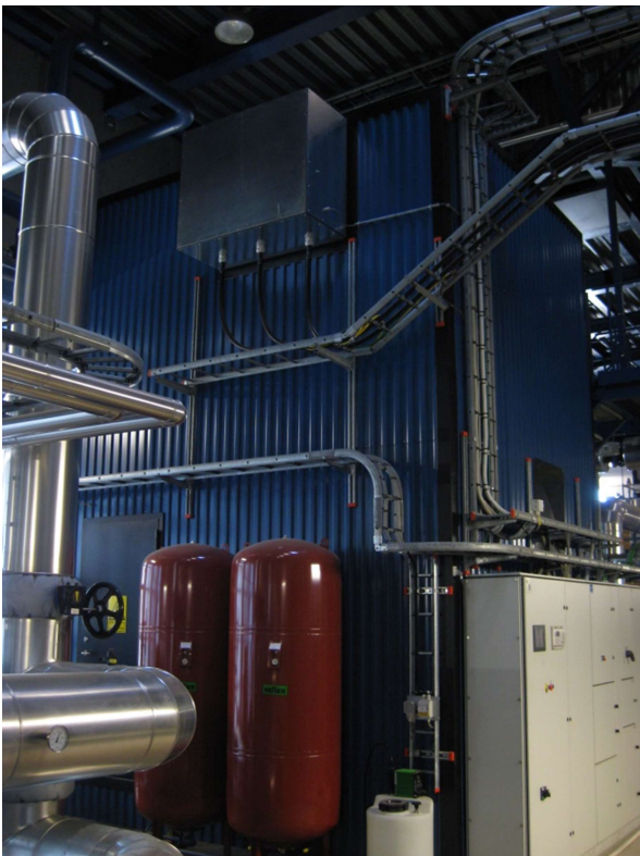
Elkedel på fjernvarmeværk, ydelse 12 MW.
