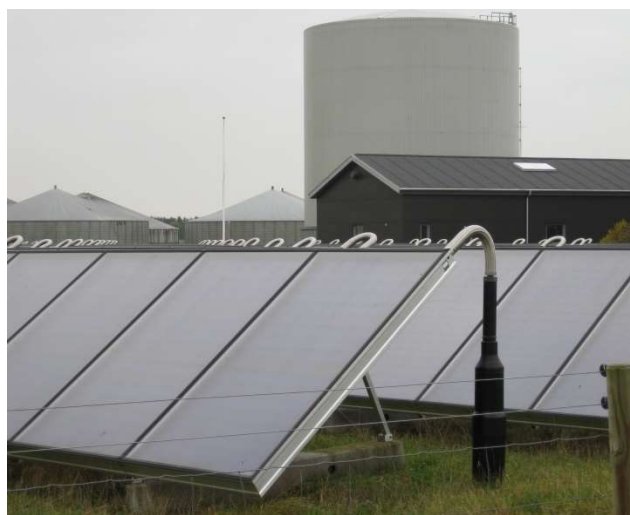
Solfangeranlæg i tilknytning til fjernvarmeforsyning
