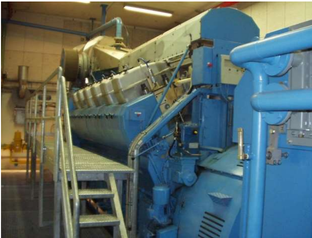
Gasmotor på decentralt kraftvarmeværk. Selve motoren er af støjhensyn mv. opstillet i en motorcelle; varmevekslere til køling af røg mv. er opstillet udenfor motorcellen.
